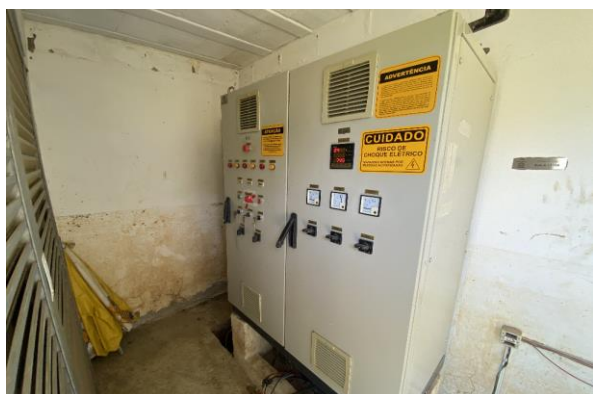
Figura 67: Vista dos Painéis de Comando da Elevatória de Água Bruta.
