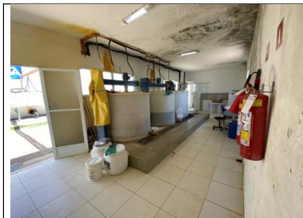
Figura 76: Vista da Casa de Químicos da ETA Jaconé.
