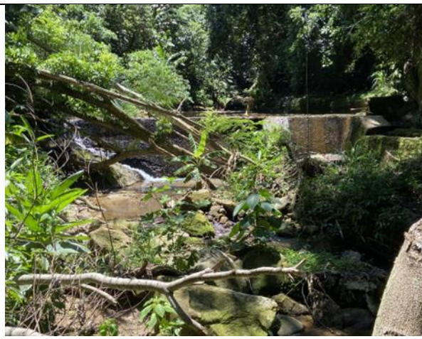
Figura 79: Vista frontal da Barragem na Serra do Pinheiros – Captação de Sampaio Correia.
