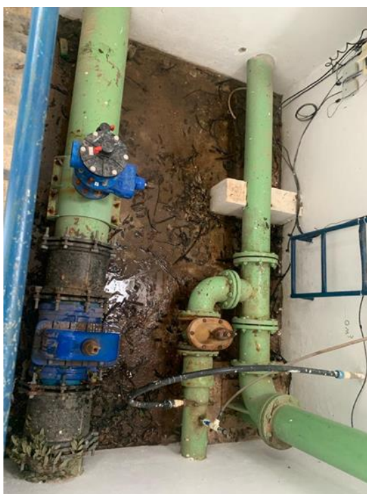
Figura 36: Detalhe das tubulações de Extravaseção e Limpeza e Saída em DN 300 que abastece Itaúna, Centro e Boqueirão.
