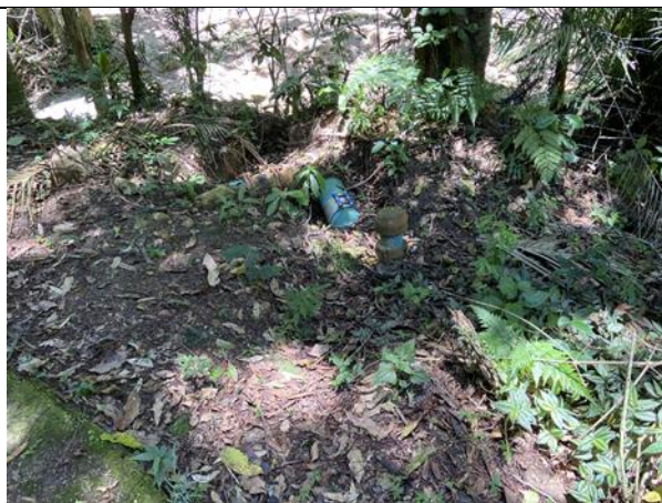
Figura 80: Adutora de Água Bruta – transição entre Ferro Fundido e De fofo.
