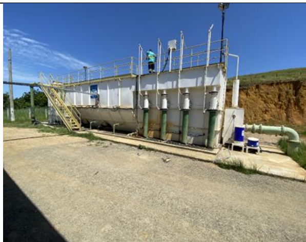
Figura 70: Vista lateral da ETA Jaconé.
