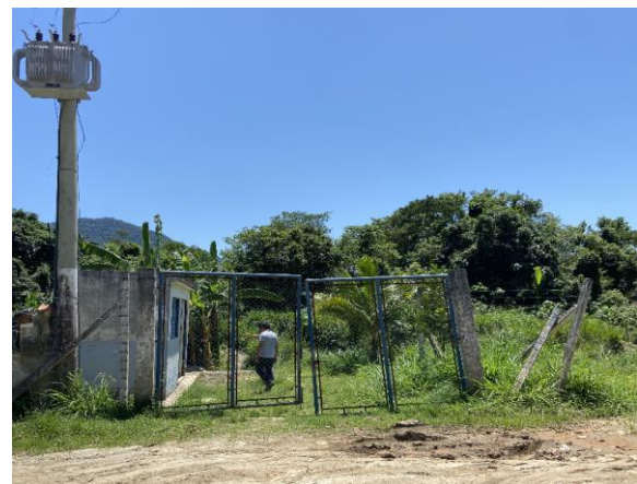
Figura 64: Vista da subestação da Elevatória de Água Bruta.
