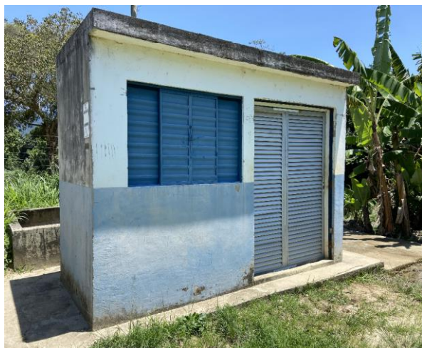
Figura 65: Vista do abrigo dos painéis de comando da Elevatória de Água Bruta.
