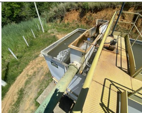
Figura 74: Vista da Calha Parshall da ETA Jaconé.
