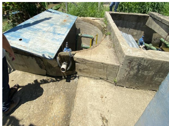
Figura 63: Vista do poço de sucção da Elevatória de água Bruta.
