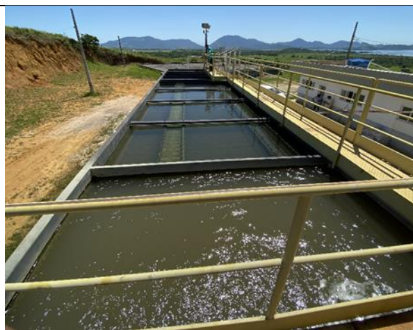
Figura 73: Vista do decantador da ETA Jaconé.
