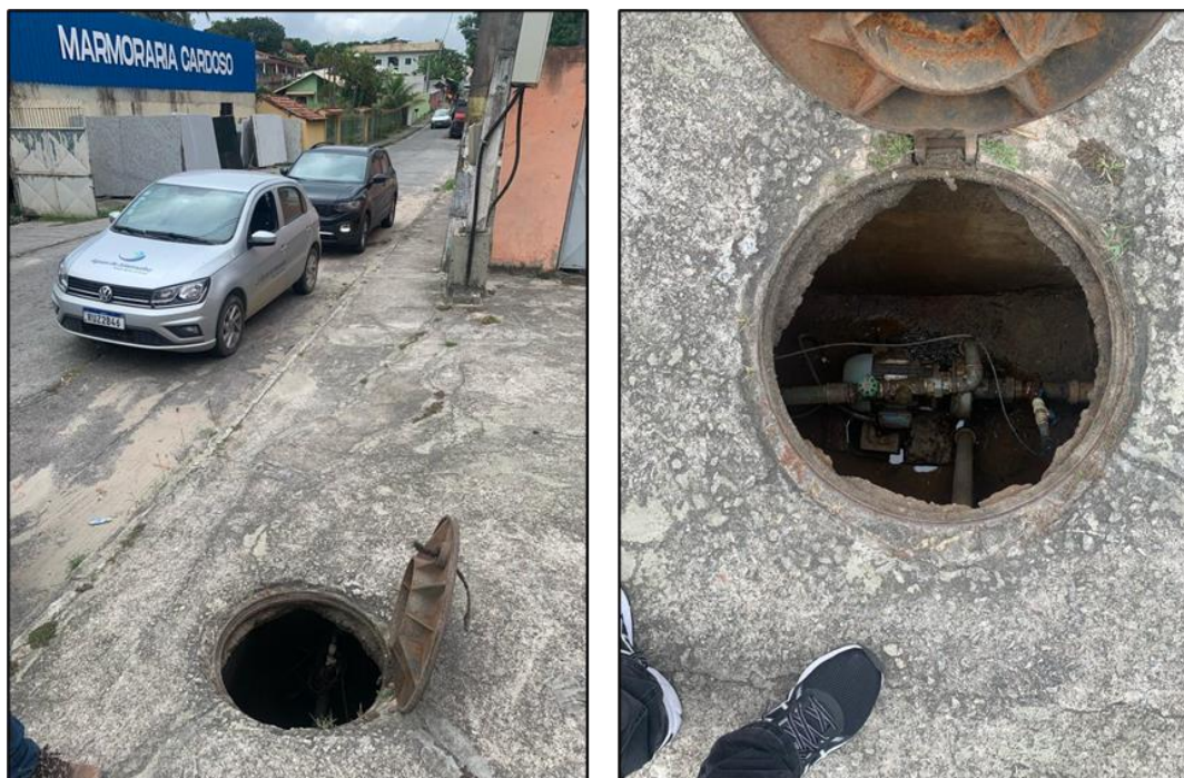
Figura 49: Booster Porto da Roça.
